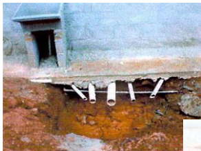
Ausência de enrijecedor de borda e solapamento do solo de apoio
